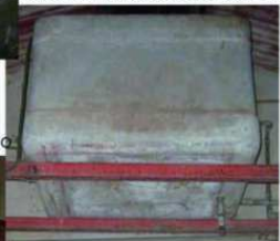
Serbatoi di accumulo, vasi di espansione
