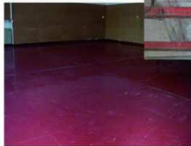
Pavimenti in vinil- amianto
