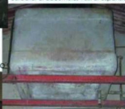
Serbatoi di accumulo, vasi di espansione
