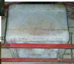
Serbatoi di accumulo, vasi di espansione
